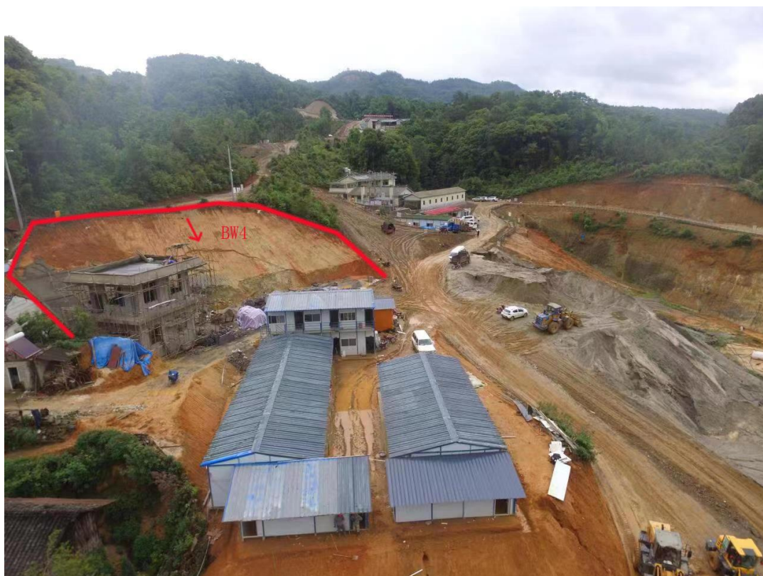
照片 4-4 BW4 不稳定边坡地貌形态
