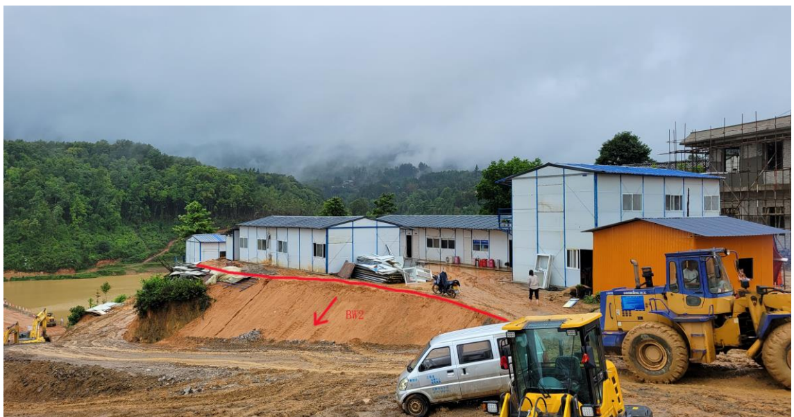
照片 4-2 BW2 不稳定边坡地貌形态
