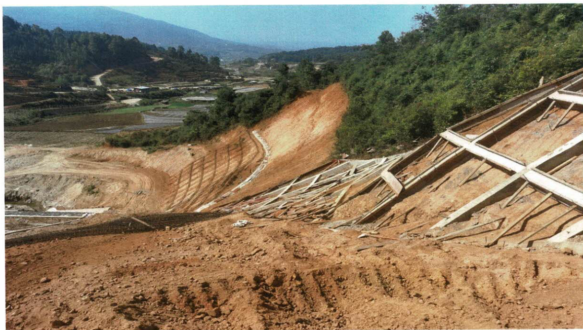
施工现场废旧模板未及时清运出场，施工区域内排水设施不完善
